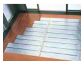
ガス温水式床暖房
